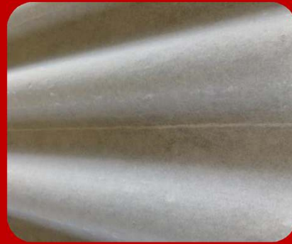
SURGIMIENTO DE GRIETA LONGITUDINAL POR MALA MANIPULACION
